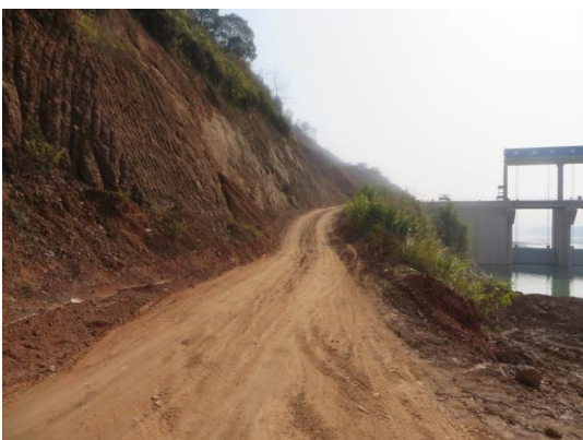
未硬化、无排水设施的施工道路
