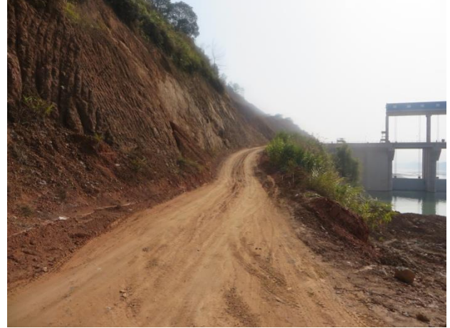
未硬化路面及裸露边坡
